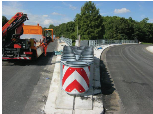
Εικόνα 1 – ΣΑΕΠ τοποθετημένο σε γέφυρα στην περιοχή των αιχμών των διαχωριστικών νησίδων
