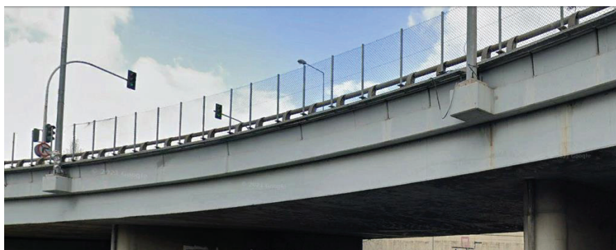
Εικόνα 3: Διάταξη στοιχείου σκυροδέματος στήριξης ιστού οδοφωτισμού, εφαρμόζεται σε νέες γέφυρες και τοίχους
